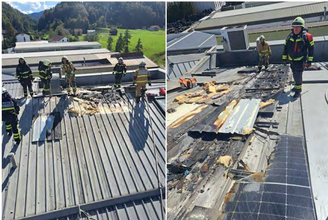
Požar sončne elektrarne na objektu Aspara
